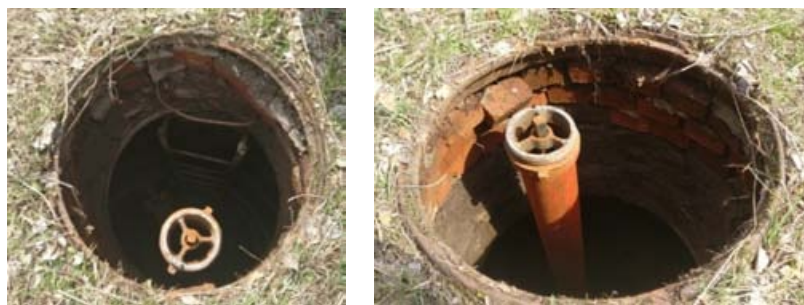
Рисунок 1. Вид пожарного гидранта с тыльной стороны МБОУ СОШ №97 г. Железногорск
