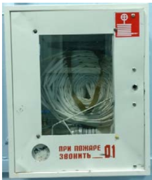
Рисунок 3. Пожарный кран в коридоре здания большого спортивного зала МБОУ СОШ № 97 г. Железногорск
